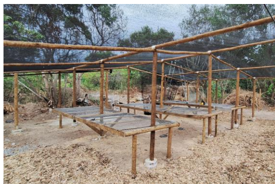
Figura 6-4 Vista interna do viveiro, observa-se as mesas gradeadas para a inserção dos tubetes de mudas. Fonte: Carpe, 2025.
