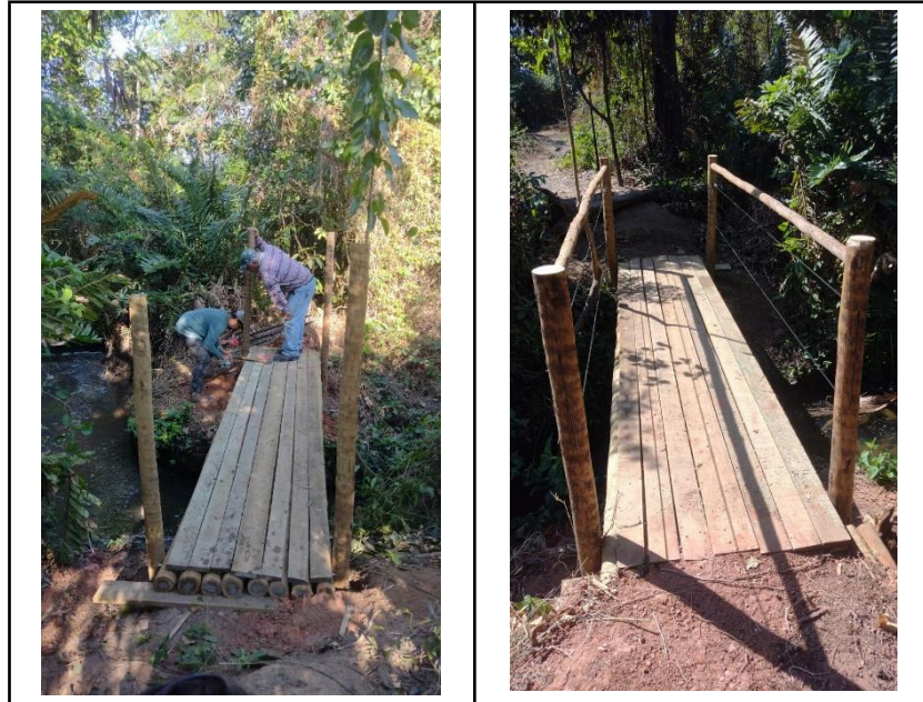
Figura 14- Concluída a instalação da ponte de ligação entre o Espaço Colibris e o Mangue Real.
